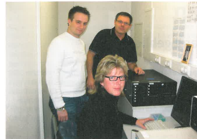
Frau Bockholt mit Christian Weihmann (Projekttechniker BRZ, hinten links) und Ron Rümmler (Projektleiter BRZ, hinten rechts) im beengten Serverraum
